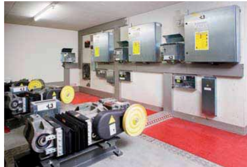
Instalación comercial Triplex operada por el grupo tractor DR SGB 142 vinculado al control de maniobra CO MX
