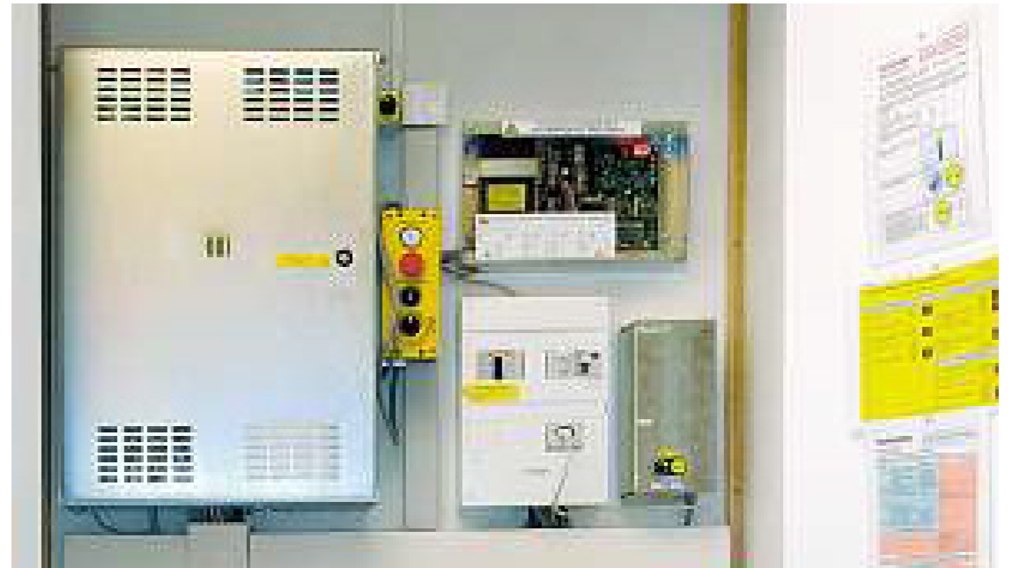
Cuarto de máquinas
